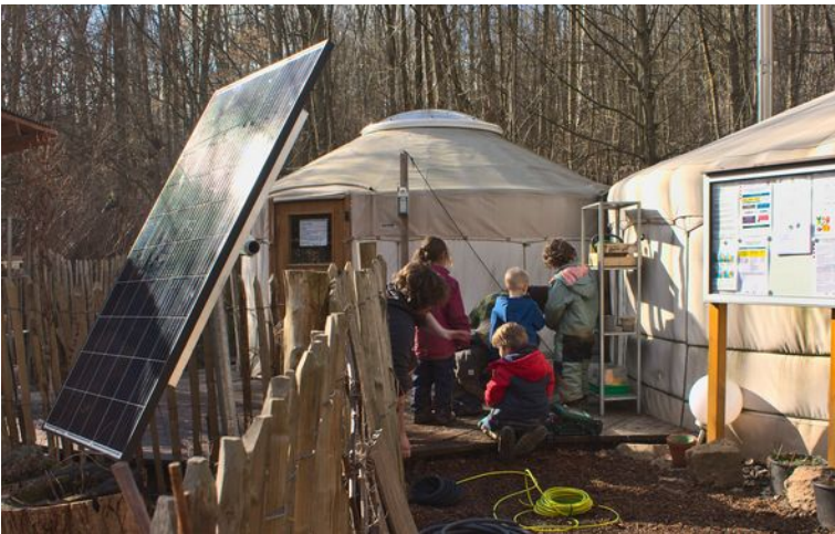
Installation einer Mini-Solaranlage bei einem Waldkindergarten im Rahmen der Kooperation mit DGS und cdw-Stiftung, 16.03.2021
